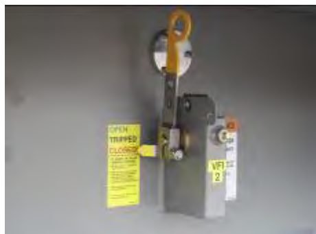
VFI Load Side
